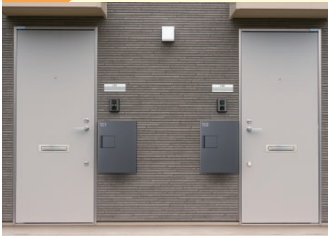
設置例 1 各戸の扉付近に設置
